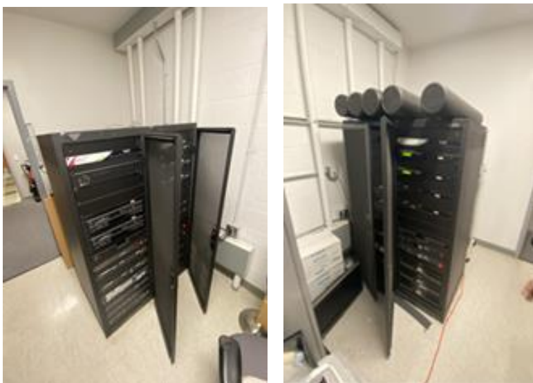
Two typical AV Racks and components in AV Rooms 110 and 111 to be removed
