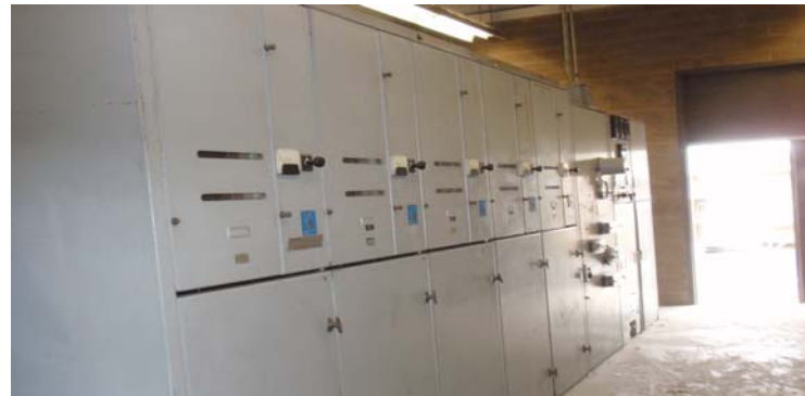
Main 5KV Switchgear
